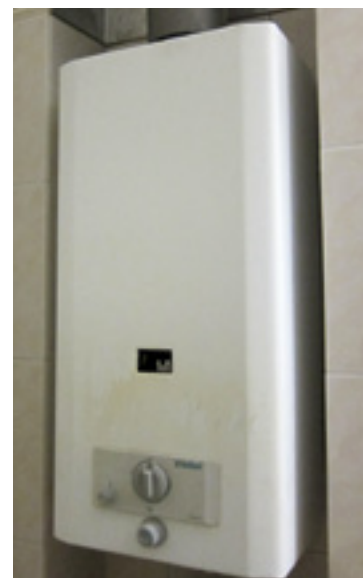
Bei diesem Gerät funktionierte die Rückstromsicherung nicht – mit fatalen Folgen.
