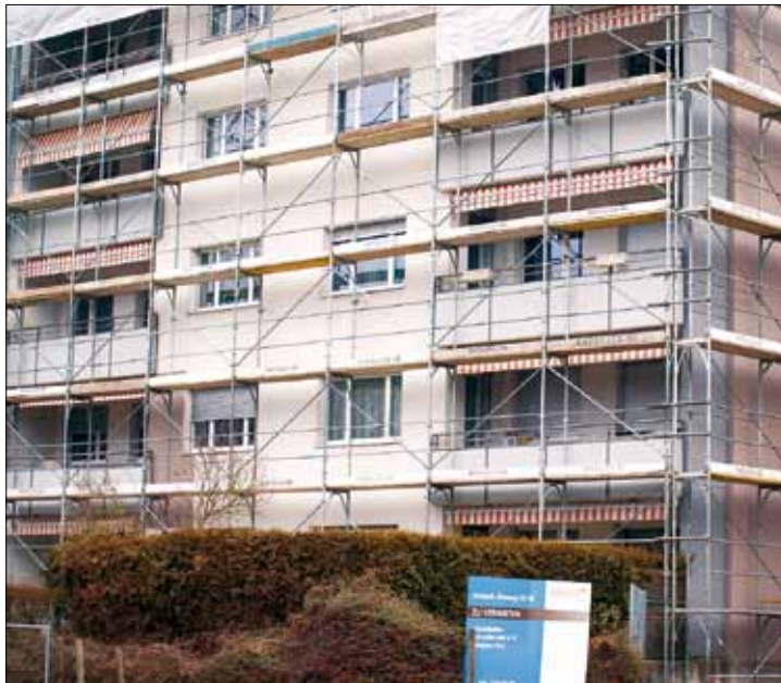
Nicht selten werden – wir hier am Birsweg Dornach – Mietzinserhöhungen noch vor Abschluss der Bauarbeiten verschickt.
