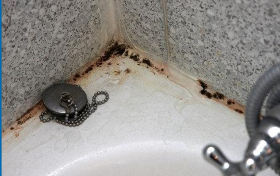
Schimmelpilz in Badfugen und Fensterfugen
